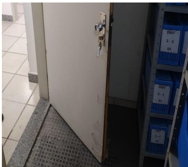
Figura 9. À esquerda: porta danificada do 3º andar, arquivo 2 e à direita: porta danificada do 3º andar, copa.
