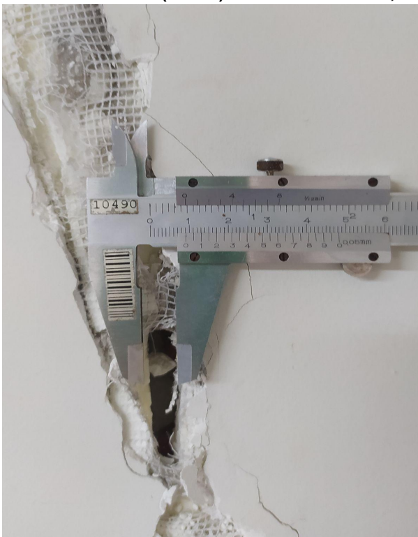
Figura 3. À esquerda: rachadura do 3º andar (sala 4), com abertura de 2,50 mm e à direita: fenda do 3º andar (sala 8) com abertura de 9,20 mm.
