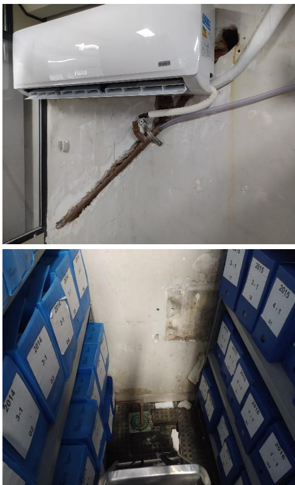
Figura 5. À esquerda: ligação dos drenos no 3º andar, sala 36 e à direita: infiltração, mofo e bolor no 3º andar, arquivo 2.
